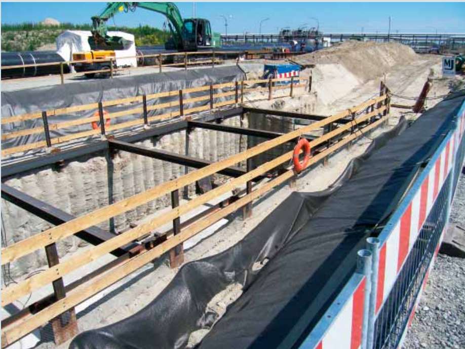
Die Startbaugrube musste so hergestellt werden, dass die hohen Vorschubkräfte des Pipe Thrusters in den Baugrund eingeleitet werden konnten.
